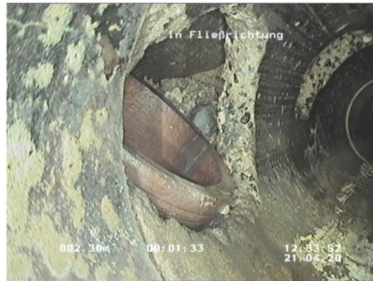
Foto-Nr. 142 2,3m 00:01:33 schadhafter Anschluss, zurückliegend, Pos. 10
