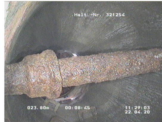
Foto-Nr. 340 23,8m 00:08:45 Endknoten
